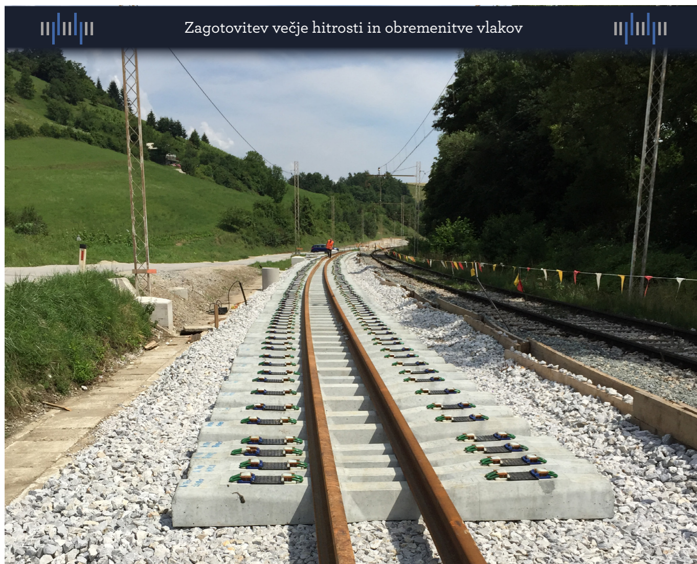
Hkrati z obnovo obeh tirov je potekala sanacija poškodovanih in dotrajanih objektov spodnjega ustroja.
