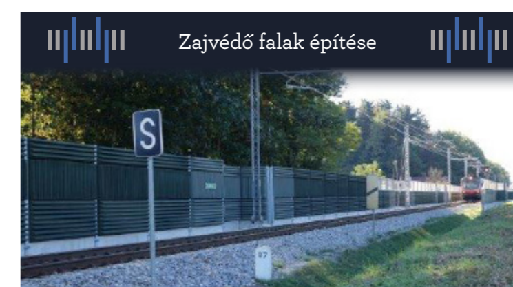
Zajvédő fal felállítás a strnišcei állomás menti pálya egy szakaszán. Jól látható a villamoshálózat is, amely a villamosított vasúti pálya részét képezi.
